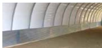
Schutzblech an der Innenwand 0,90 / 1,70 / 2,50 m hoch
