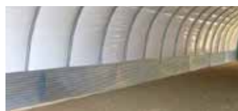
Schutzblech an der Innenwand 0,90 / 1,70 / 2,50 m hoch
