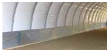
Schutzblech an der Innenwand 0,90 / 1,70 / 2,50 m hoch
