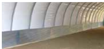
Schutzblech an der Innenwand 0,90 / 1,70 / 2,50m hoch
