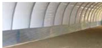
Schutzblech an der Innenwand 0,90 / 1,70 / 2,50 m hoch
