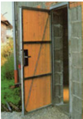
Tür ohne Isolierung innen
